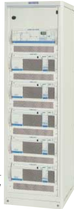
Figura 5: Instalación de inversor 5 x 2,5 kVA con EUE
